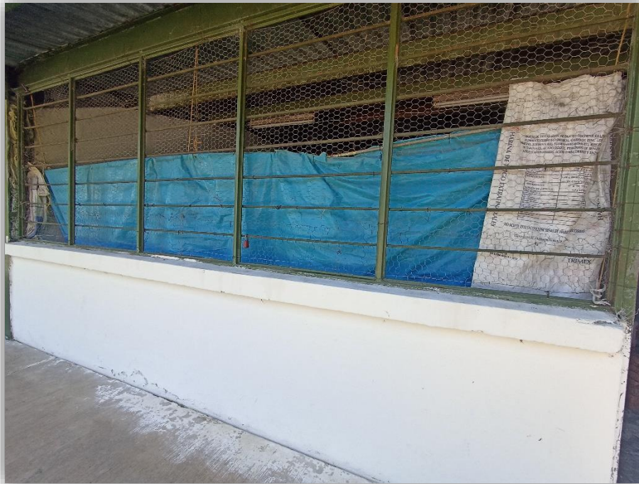
Figura 7. Cortinas de plástico para regular la ventilación de la nave
